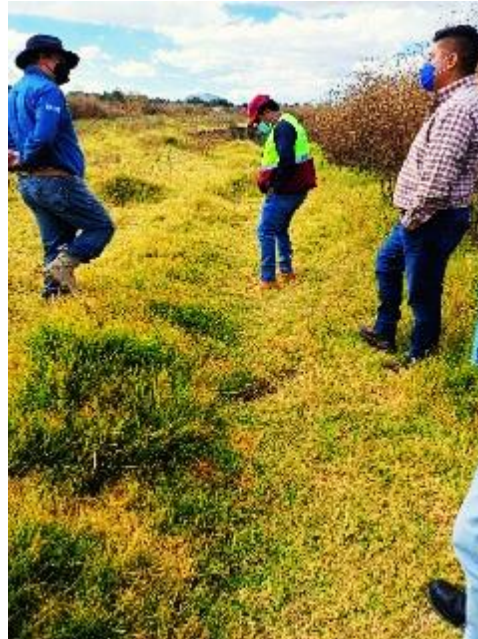
FOTOGRAFÍA 17: OQUEDADES Y FRACTURAS EN EL SUELO A LOS ALREDEDORES DEL SOCAVON.
