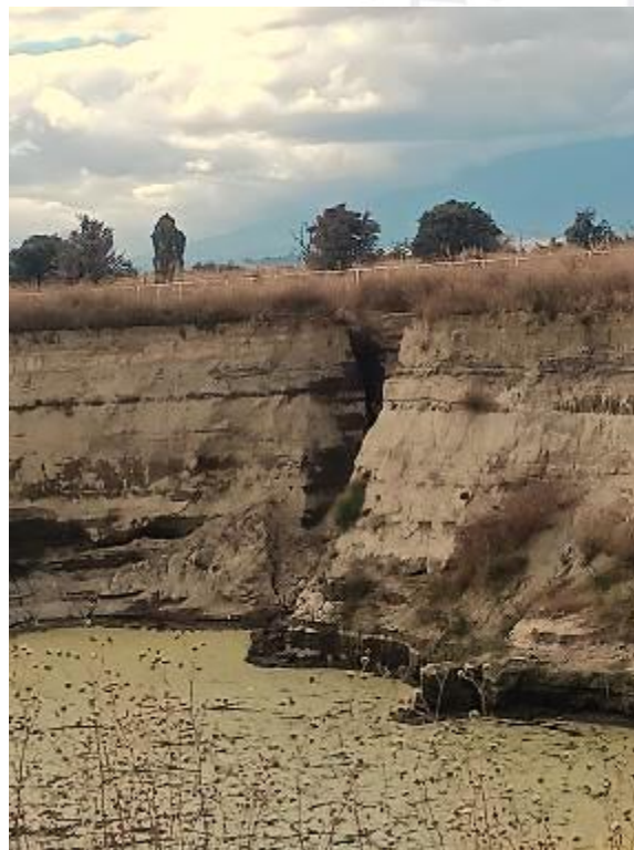
FOTOGRAFÍA 12: FRACTURA DENTRO DEL SOCAVÓN.
